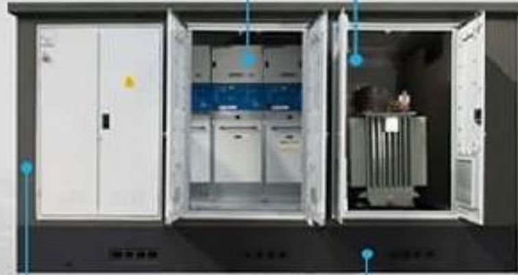
Kompakt Trafö Mezasları
